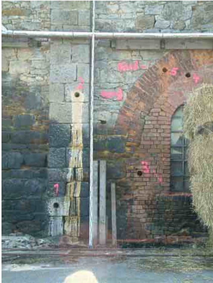
Abbildung 6.15: Deutlich erkennbare, dunkle Verfärbungen durch Chromat
