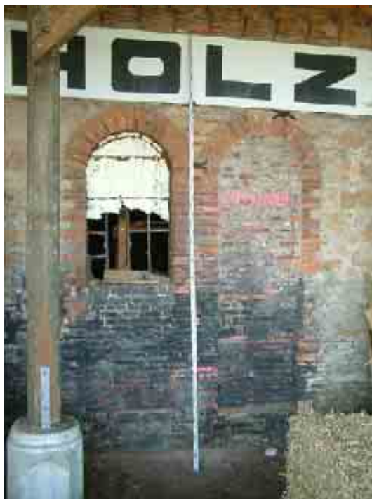
Abbildungen 6.16-6.18: Die Mauerwerke aus Sandstein und Ziegeln sind bis in den Kern stark chromathaltig. Links zu erkennen an der dunklen, rechts an der schwarzen Verfärbung des Mauerwerks.
